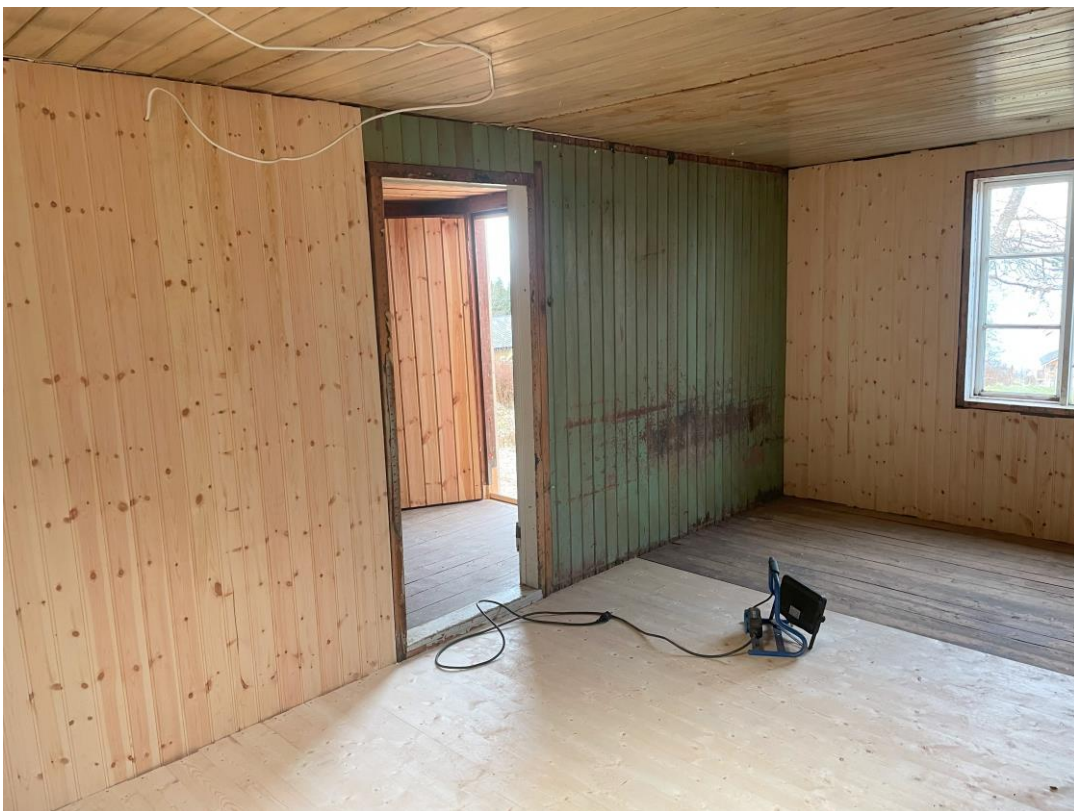
Kun litt av det gamle gulvet kunne gjenbrukes. Ellers er nytt gulv lagt. Gulvet ligger på nye tilfarere i grus. Siste 10 cm opp til gulv er fylt med lecakuler.
